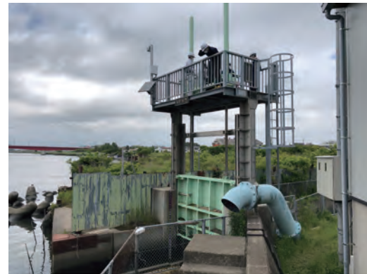
栄町水門：ゲート稼働
