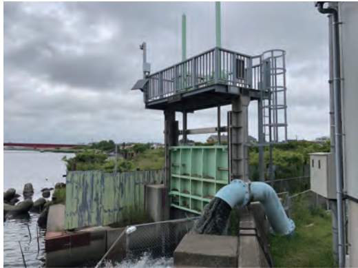
栄町水門：ポンプ稼働
